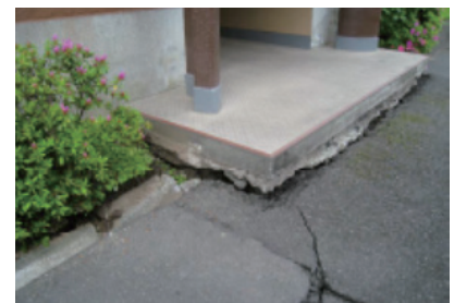
〈地盤が沈下し、液状化が発生〉
