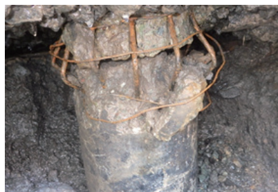
〈損傷した杭の様子〉
